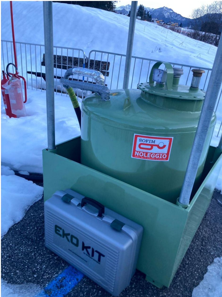
Cisterna di alimentazione con vasca stagna per la raccolta di eventuali perdite
