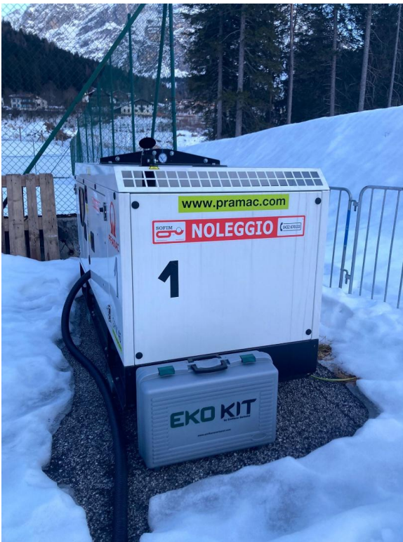
generatore posizionato su pavimentazione in asfalto
